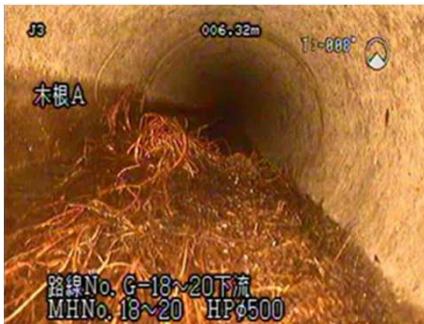
○小金井団地排水管内 木根侵入状況
