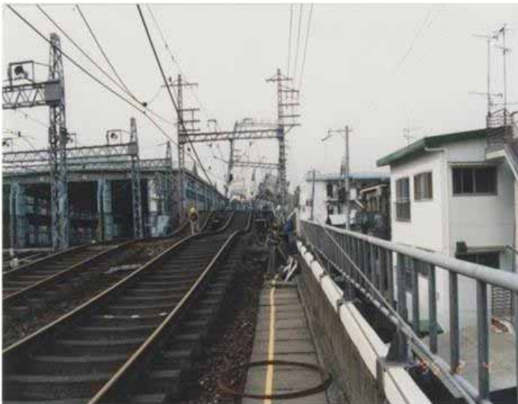
神戸高速新在家駅とゆがんだレール
