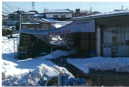
写真右: 2014年2月の大雪で被災したパイプハウス
