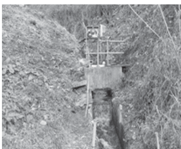
市民グループによるマイクロ水力発電実証実験（伊那谷自然エネルギー研究会・長谷中山集落発電所） Micro hydro power generation equipment installed by a local group (Inadani Natural Energy Study Group/ Hasenakayama Community Power Station)
