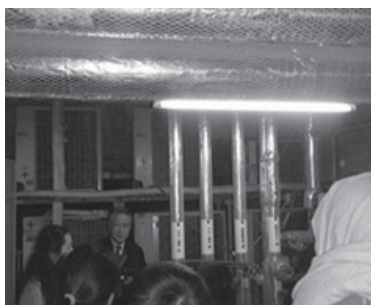
温泉の排湯を利用したヒートポンプ（三宜亭本館） Heat pump facility utilizing overflowed hot spring (Sangitei Honkan Hotel)
